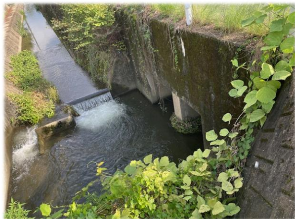
排水路内に設置された魚道
